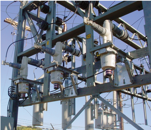
Instalação retrofit com módulo Z. Religador Viper-ST em quadros individuais.
