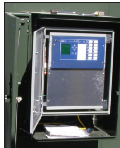
Controle localizado em um Trident automatizado
